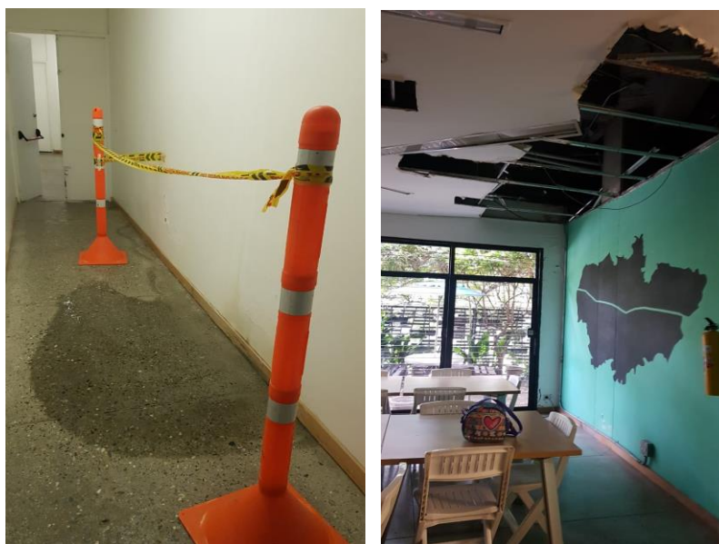
Ilustración 2 Demarcación de área por riesgo a caídas
