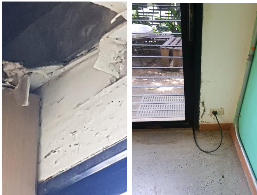
Ilustración 3 Humedad en pisos y paredes
