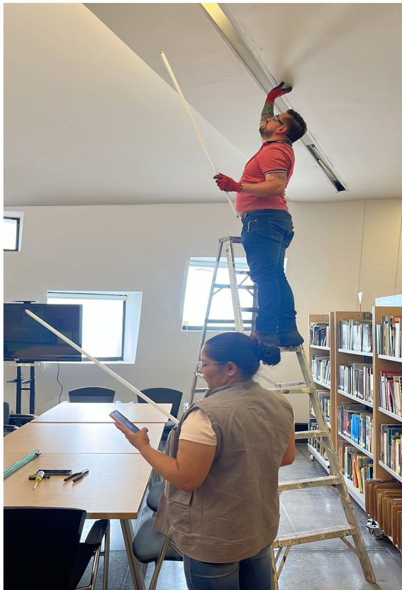
Ilustración N°7 Cambio luminarias Internas MCM
